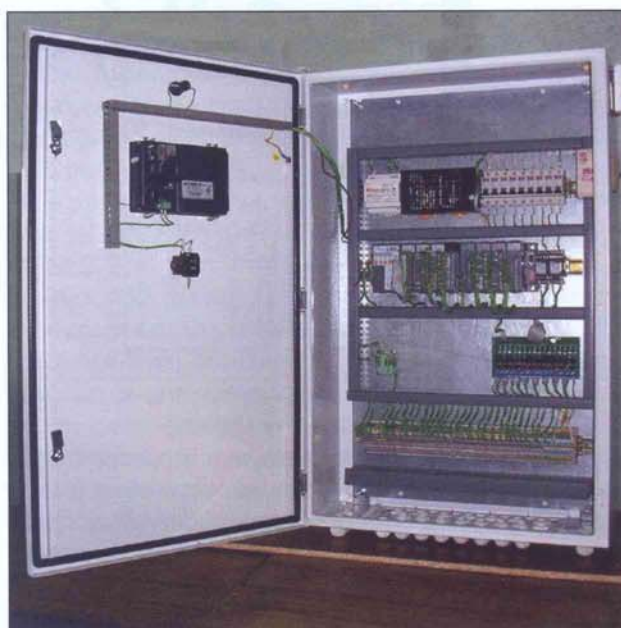
Рис. 6. Внутренний вид щита управления.
