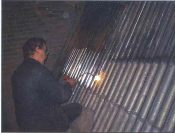
Рис. 1. Читинская ТЭЦ-2. Наплавка износостойкого материала на трубы заднего экрана на высоту 1,5 м над слоем.
